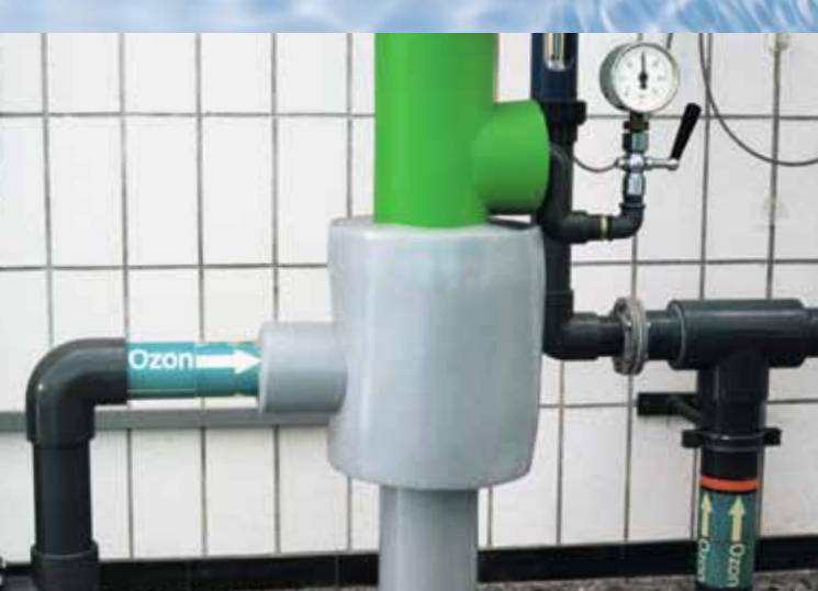
原水通过一根 700m 长的管道从康斯坦茨湖抽取上来并送至微滤器过滤，然后使用臭氧进行消毒。臭氧通过周围的空气直接在自来水厂中生成。
