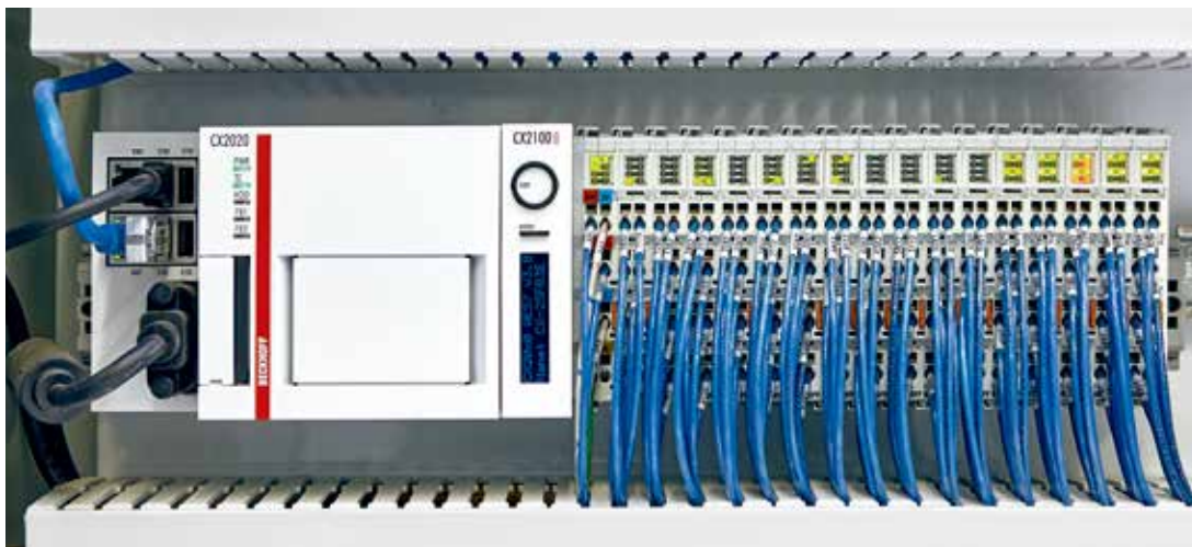
泵站通过直接插接 EtherCAT I/O 的 CX2020 嵌入式控制器控制
